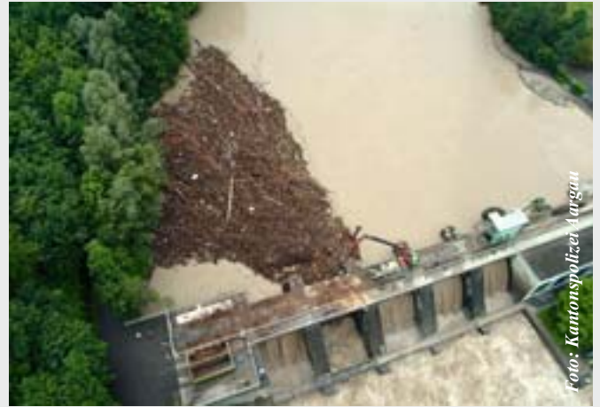
Schwemmholz in der Reuss bei Bremgarten-Zufikon
