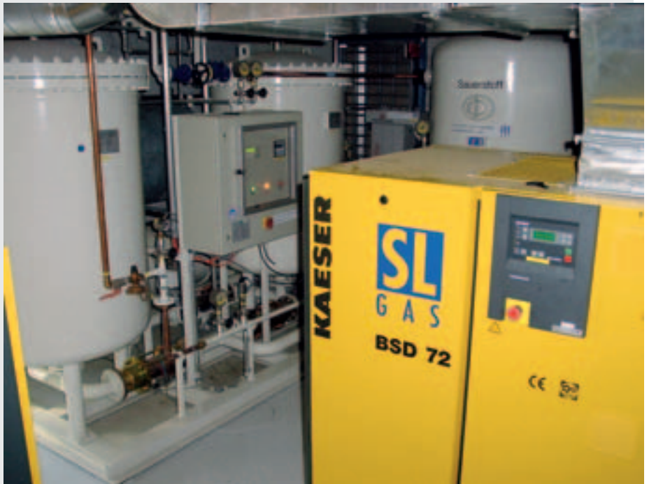
Blick in die kompakte Anlage zur Anreicherung von Sauerstoff im Betriebsgebäude der Seebelüftung
