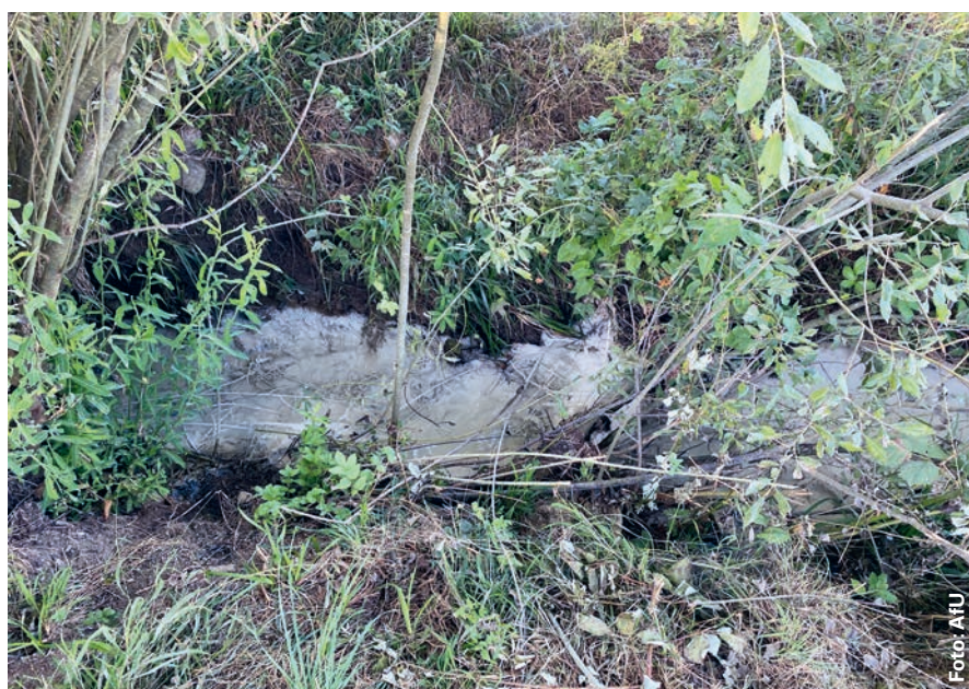
Diese Gewässerverschmutzung – weisse Ablagerungen und ein pH-Wert von 10 – entstand durch die Ableitung des Baustellenabwassers aus der Baugrube ohne Absetzbecken und Neutralisation. Das Bachufer musste mit einem Saugwagen gereinigt werden.
