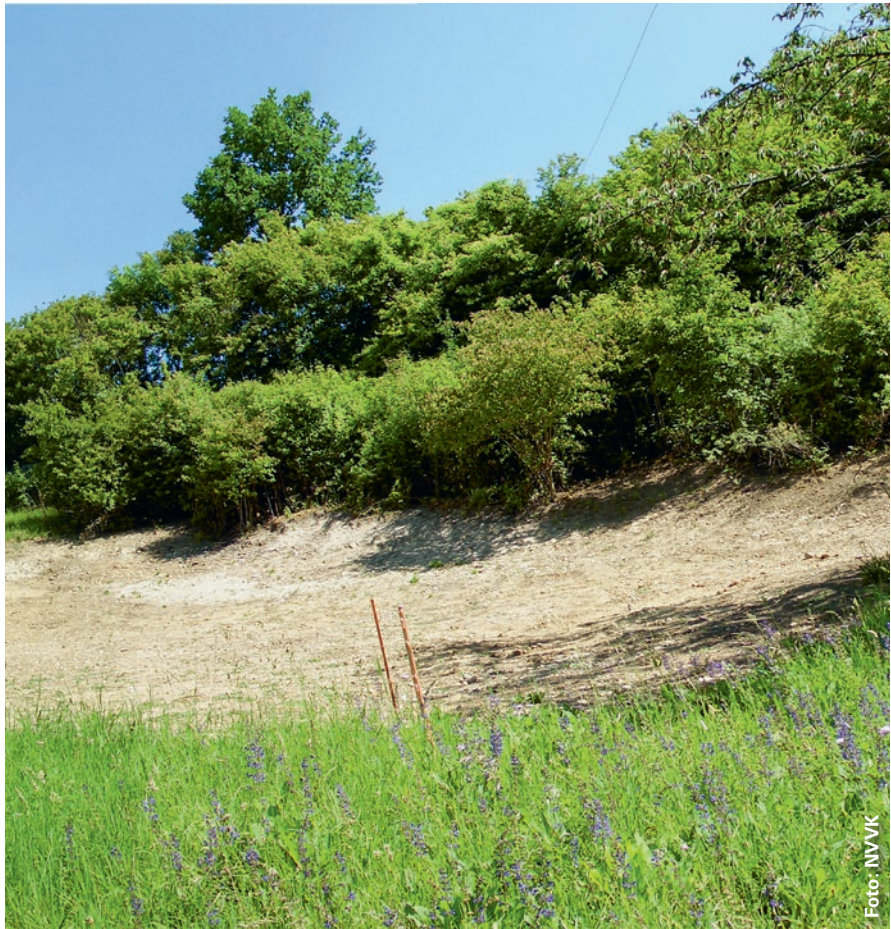
Hier wucherten hauptsächlich Brombeeren. Nachdem der nährstoffreiche Boden abgetragen wurde, konnte die Magerwiese eingesät werden.
