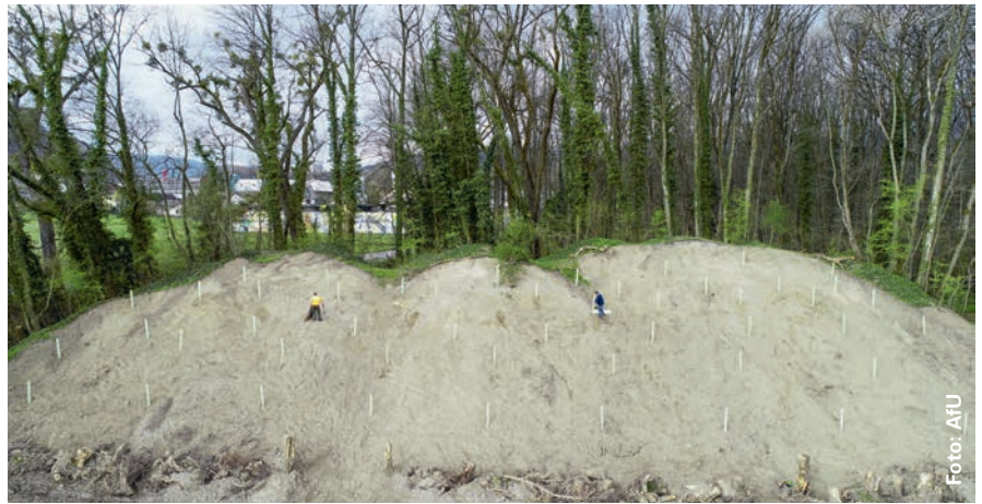
Als letzter Schritt der Sanierungsarbeiten wurden die Kugelfänge – wie hier beim «alten Chugelefänger» – mit standorttypischen einheimischen Sträuchern und Bäumen aufgeforstet.
