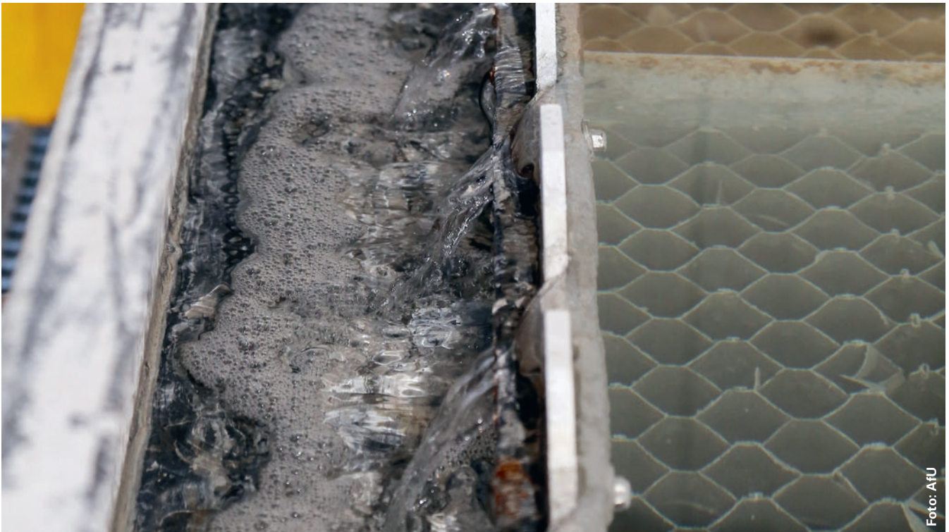
Austritt des gereinigten Abwassers beim Lamellenschrägklärer: Hier werden noch die feinsten Schwebeteilchen aus dem Wasser entfernt.
