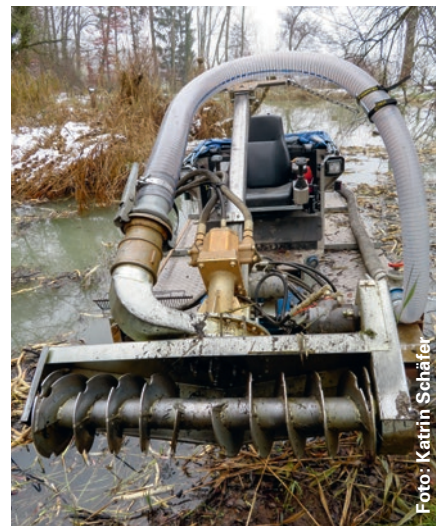
Pumpeinheit des amphibischen Saugbaggers: Zu sehen sind die «Schnecke», die den Boden aufräst bzw. aufwühlt, und ein Teil des Druckrohrs, mit dem das Schlamm-Wasser-Gemisch an Land gepumpt wird.
