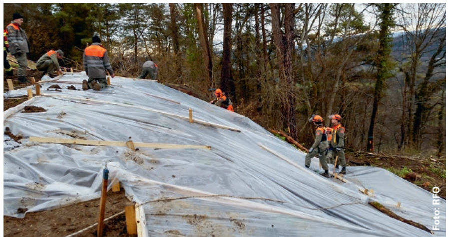
Mit der Plastikfolie sollte verhindert werden, dass Oberflächenwasser in den Rutschkörper eindringt und eine weitere Rutschung verursacht (12. Februar 2016).
