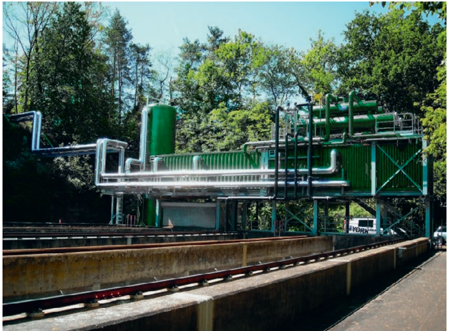
Container mit zwei Wärmepumpen über dem Nachklärbecken der ARA Rheinfelden-Magden.
