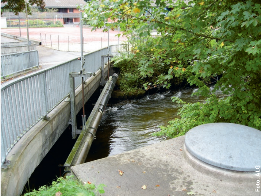
Bei der alten Paradiesbrücke in Wildegg schränkte eine vorgehängte Kanalisationsleitung das Abflussprofil zusätzlich ein.
