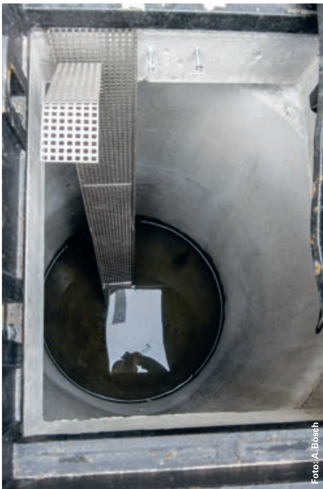
Eine Lochblechschiene, die nahezu senkrecht ist und oben an den Rost anstösst, ist als Ausstiegshilfe nur bedingt geeignet.
