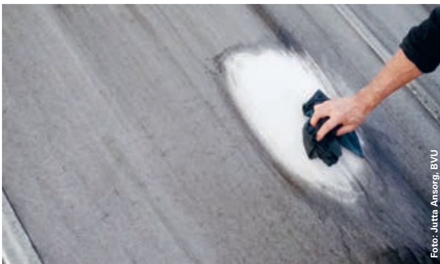
Der Pilzbelag, hier auf einer Lichtkuppel, lässt sich mit Wasser entfernen.
