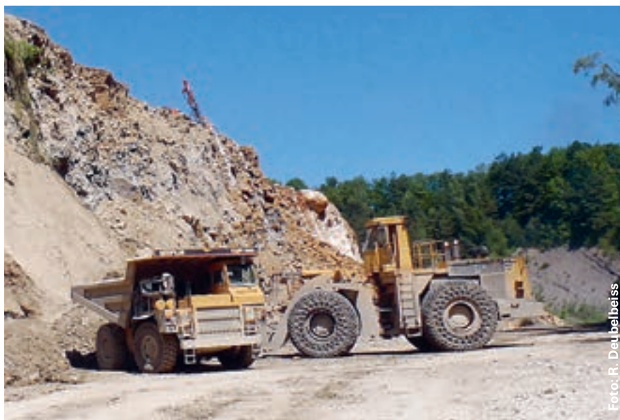
Der Erratiker wird durch Wegsprengen des Umgebungsgesteins aus der Kalk-Felswand zur Hälfte freigelegt und dadurch in seinen grossen Ausmassen erkannt.
