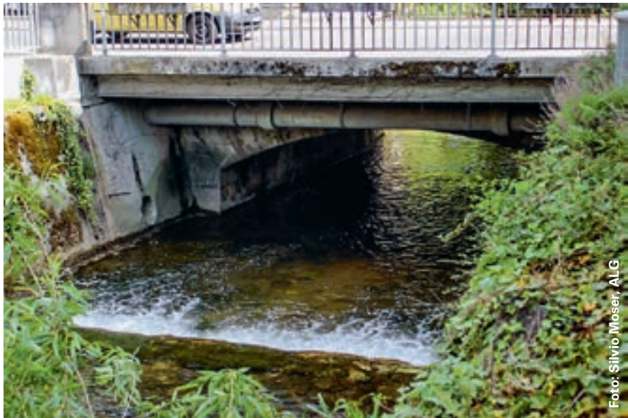
Da ihr Abflussquerschnitt ungenügend ist, muss die Brücke Zentralstrasse in Wohlen erneuert werden.
