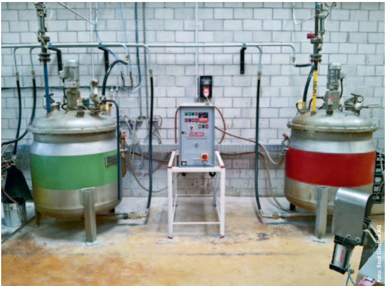
Zwischen den zwei Rohstoffbehälter für die Schaumstoffproduktion ist das neue Kühlgerät zu sehen.
