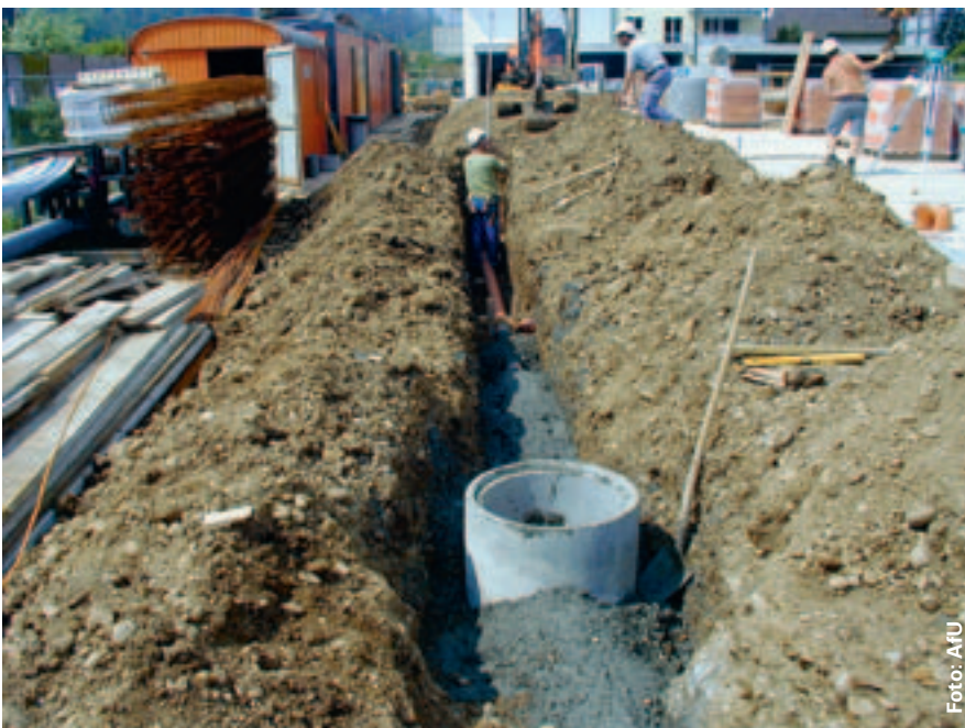
Hausanschlüsse weisen oft einen schlechteren baulichen Zustand auf als die Gemeindekanalisation.
