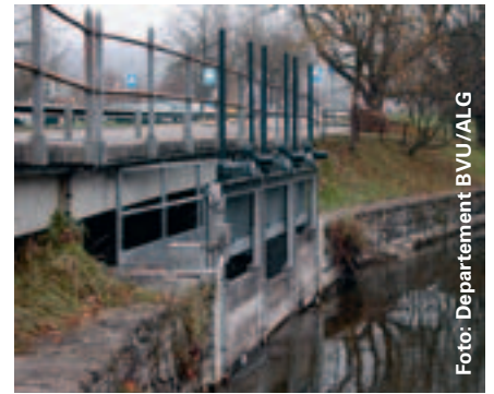
Hallwylersee: Auslastyp Wehr für eine optimierte Seeregulierung
