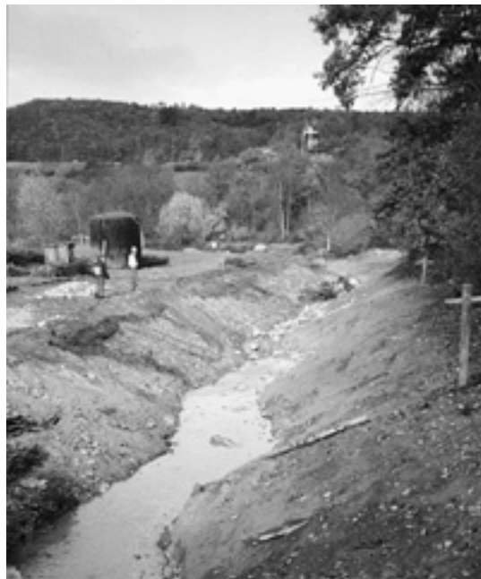
September 1997: Die Arbeiten am neuen Umgehungsgewässer sind beendet, das Gerinne wird in Betrieb genommen.
