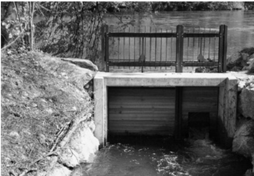
Einlauf der Limmat in das Umgebungsgewässer mit der neuartigen Tafelstütze für die Wasserregulierung.
