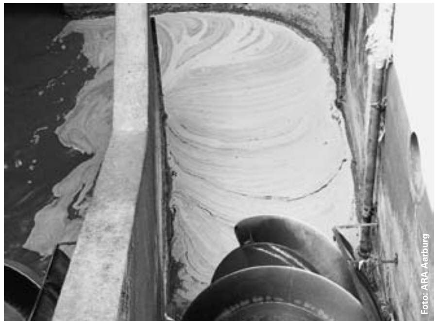
Fettfracht im Schneckenpumpwerk
