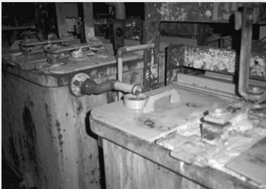
Vor Inkrafttreten des eidgenössischen Umweltschutzgesetzes von 1983 waren Schutzvorrichtungen gegen das Austreten und Versickern von wassergefährdenden Flüssigkeiten nicht sehr verbreitet.
