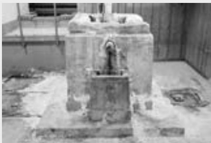
Der Quellstock im Hotel Schwanen heute. Man beachte die starke Ausblüfung von Mineralien (Sulfate, Karbonate, Salze) und das aufgesetzte Standrohr (Schwanenpegel).
