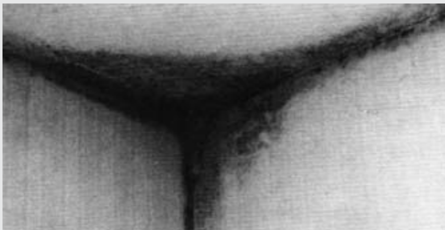
Graue Ecken entstehen bei tiefen Oberflächentemperaturen auf der Innenseite der Aussenwand. Erhöhte Luftfeuchtigkeit verstärkte in diesem Fall die Bildung von grauen Ecken.
