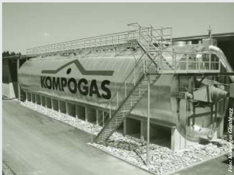
Neue Kompogas-Anlagen sind modular mit standardisierten Anlagenteilen aufgebaut. Das Foto zeigt die Kompogas-Anlage in Oetwil am See.
