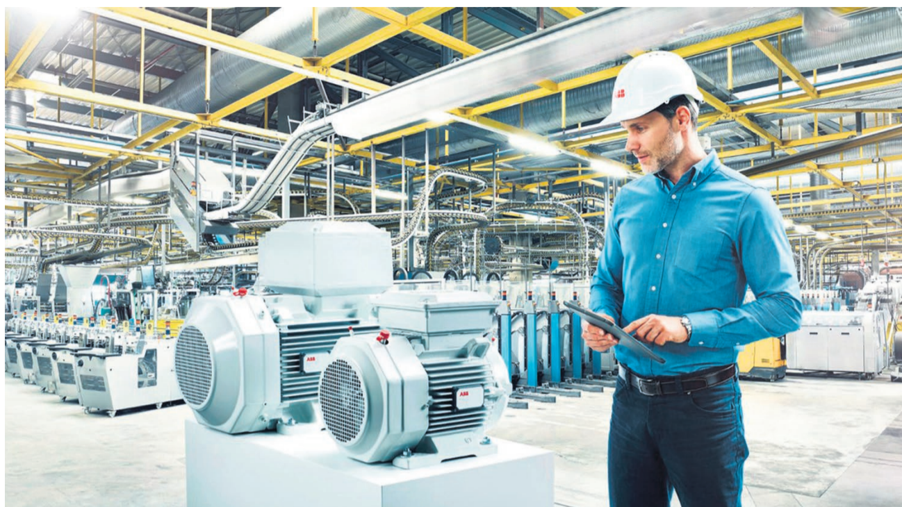
Smart Sensor: Die Erfassung der Zustandsdaten einer grossen Zahl von Motoren trägt zur Optimierung des Anlagenbetriebs und zur Senkung des Energieverbrauchs bei. (Bild: ABB)
