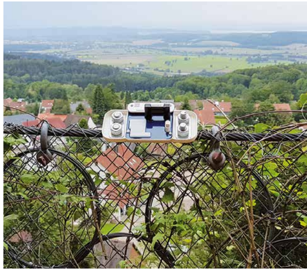
Ein Sensor-Prototyp im Einsatz: Er liefert Messdaten zur fortschreitenden Korrosion des installierten Seils.
