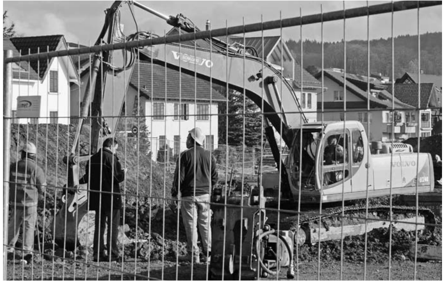
Bei der Arbeit: Spontan kontrollieren die Inspektoren eine Baustelle in der Nähe von Aarau.
