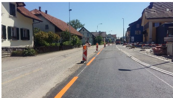
Abb. 5: Markierung auf neuem Belag
