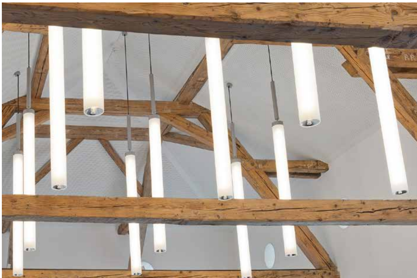
Infrastruktur auf dem neusten Stand: In der Aula, der ehemaligen Malerei, wurde 2024 die Beleuchtung erneuert.
