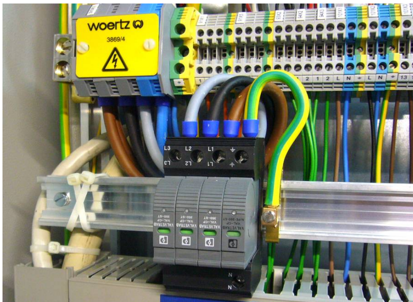
Bild 11 Überspannungsschutzelement mit direkter Erdung auf der C-Schiene
