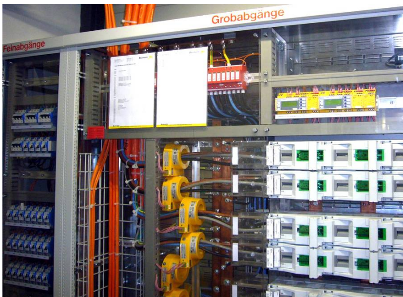
Bild 41 Jeder Grobabgang ist mit einem eigenen RCM bestückt. Bei einem Fehlerfall ist bereits eine erste Zuordnung möglich
