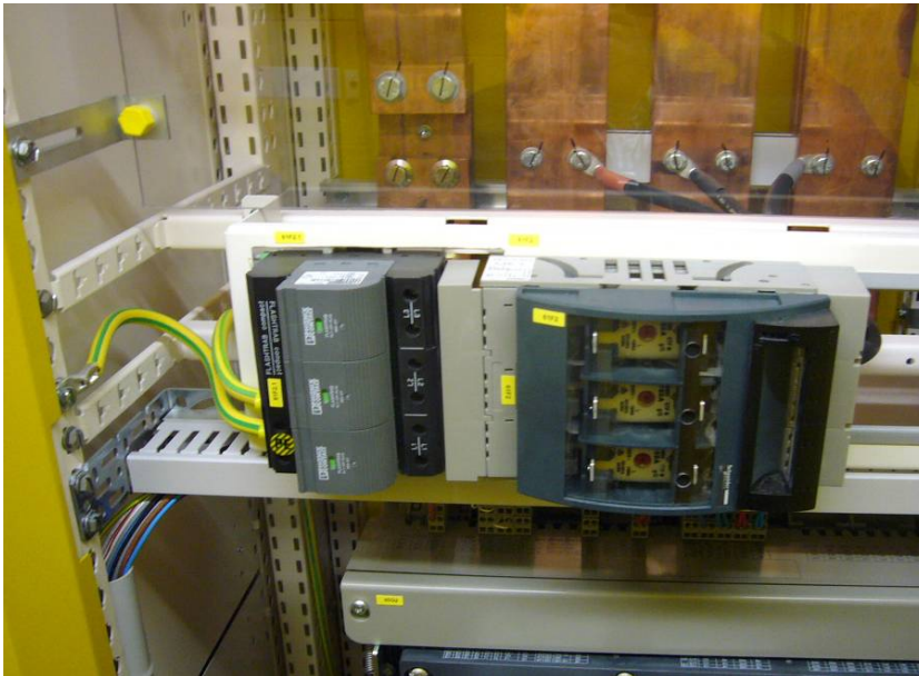
Bild 13 Überspannungsableiter Typ 1 mit Versicherung und direktem Anschluss auf die Rahmen- konstruktion
