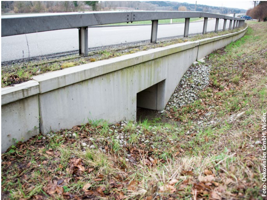
Die fest installierte Leiteinrichtung bei Unterlunkhofen lenkt die Tiere zur Unterführung hin und kann von Amphibien nicht überklettert werden.
