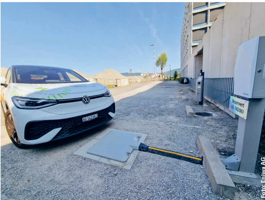
Induktive Ladestation, installiert bei der Eniwa AG in Buchs: Das umgerüstete E-Auto wird über die im Boden integrierte Spule automatisch aufgeladen, sobald es richtig parkiert ist.
