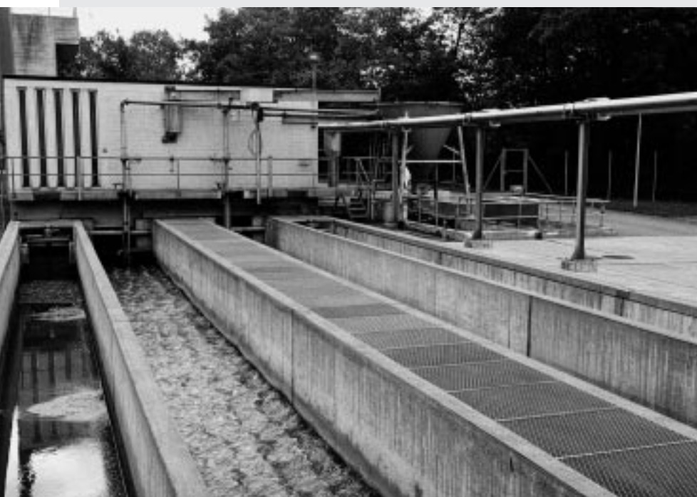
Sand- und Fettabscheideranlagen der Abwasserreinigungsanlage Lenzburg-Wildegg
