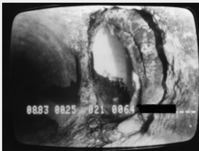
Das Kanalfernsehen ermöglicht es, schadhafte Kanalisationsanschlüsse zu finden.
