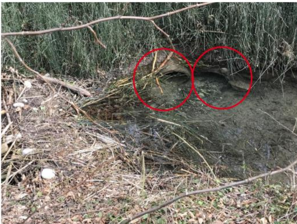
Weitere zwei Entwässerungsleitungen, welche eingestaut sind.
