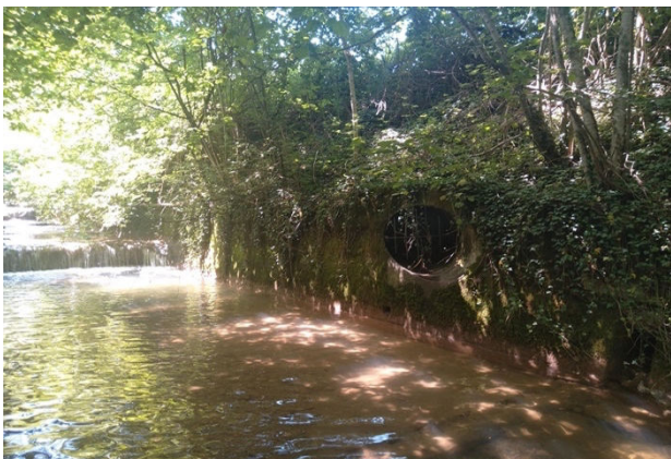
Abb. 6: Einleitung des behandelten Abwassers aus dem Regenbecken RUB Villigen in den Kumetbach. Koordinaten: 265879 / 1264205.
