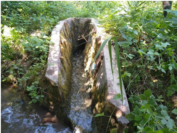
Abb. 13: Einleitung des Industrieabwassers oder Kühlwassers aus dem Areal der Ineos Compounds AG, Sins in den Schachekanal. Koordinaten: 2672865 / 1228002.
