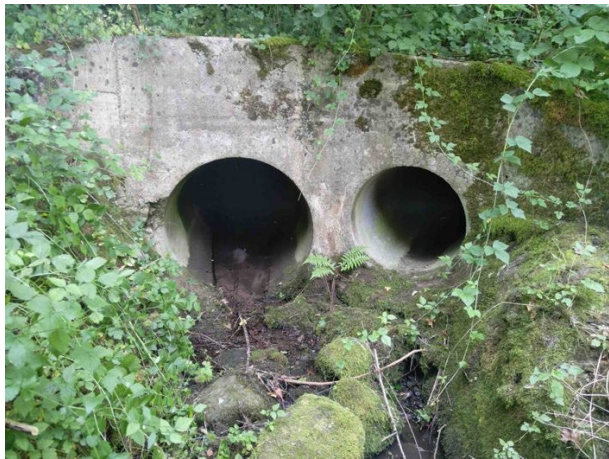
Abb. 14: Einleitung aus der Regenentlastung RU 02 und «anderem» Abwasser aus dem Industrieareal, Sins in den Schachekanal. Koordinaten: 2672854 / 1227990.
