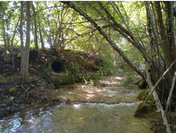
Abb. 6: Einleitung des behandelten Abwassers aus dem Regenbecken RU 96 in den Wölflinswilerbach. Koordinaten: 2641860 / 1257405.
