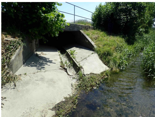
Abb. 11: Einleitung zur Entlastung des Regenbeckens RKB ARA in den Köllikerbach. Koordinaten: 2644517 / 1244208.
