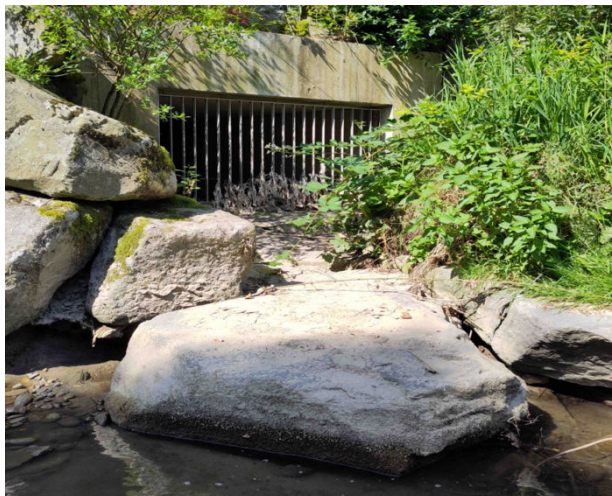
Abb. 6: Einleitungsstelle des Regenüberlaufes RU Wiggerbrücke in die Wigger. Koordinaten: 2641860 / 1257405.
