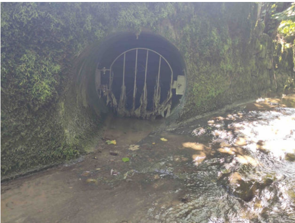
Abb. 27: Einleitung RU 401, Hornussen in den Zeiherbach. Koordinaten: 2646546 / 1261337.
