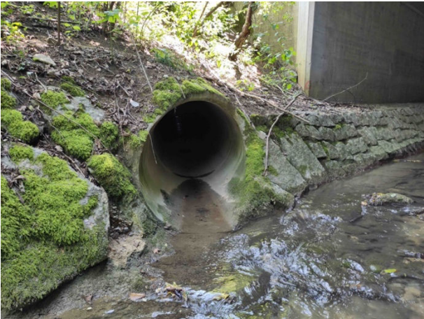
Abb. 13: Einleitung RUB N3 Bözen in die Sissle. Koordinaten: 2648186 / 1260834.
