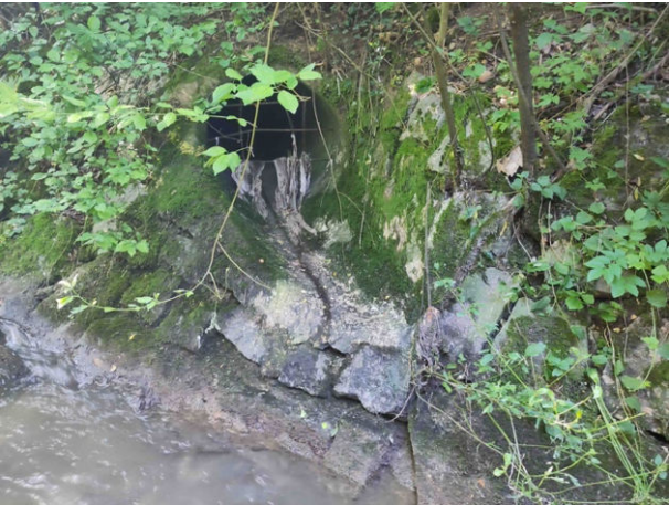
Abb. 20: Einleitung RU 181, Hornussen in die Sissle. Koordinaten: 2646311 / 1261591.
