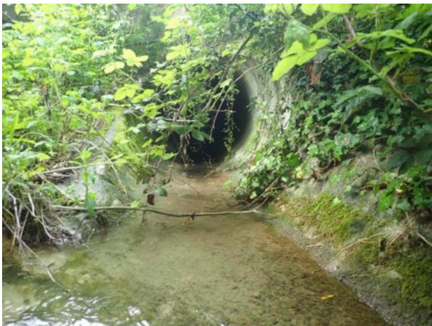
Abb. 82: Einleitung des Regenüberlaufes HE 110, Villmergen in den Hinterbach. Koordinaten: 2661127 / 1244416.
