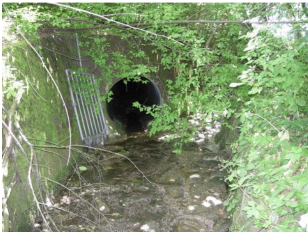
Abb. 21: Einleitung des Regenbeckens Riedmatten, Buttwil in den Dorfbach. Koordinaten: 2665'946 / 1236'085.
