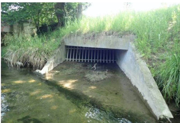
Abb. 72: Einleitung der Entlastung aus dem Regenbecken RUB Bünzmatt, Wohlen. Koordinaten: 2662794 / 1245178.
