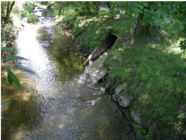
Abb. 51: Einleitung des Kühlwassers und des Abwassers der Rauchgasreinigung, Dottikon. Koordinaten: 2661'131 / 1247'352.
