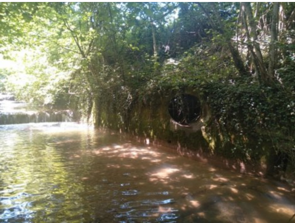
Abb. 102: Einleitung der Entlastung aus dem Fangbecken FB Hilfikon, Villmergen. Koordinaten: 2661109 / 1243166.
