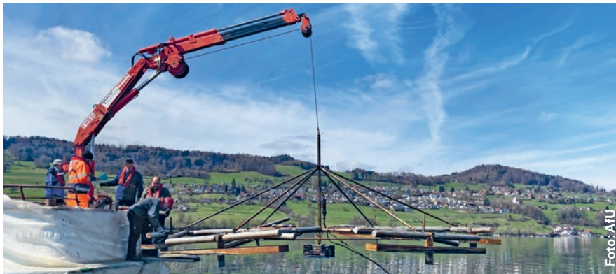
Die Seebelüftung wird in Zusammenarbeit mit der Schiffahrtsgesellschaft Hallwilersee (SGH) jährlich einem Routineservice unterzogen. Nach 40 Jahren im Einsatz ist dieses Jahr nun eine Gesamterneuerung geplant.
