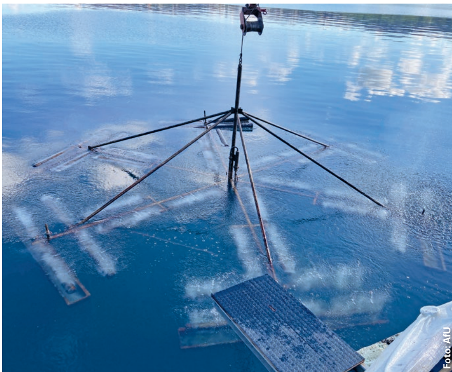
Das in die Jahre gekommene Gestänge mit den 42 Fritten wird nach der jährlichen Reinigung wieder abgetaucht. Unter Wasser bilden die aus den Diffusoren-Fritten aufsteigenden Blasen einen feinen Schleier.
