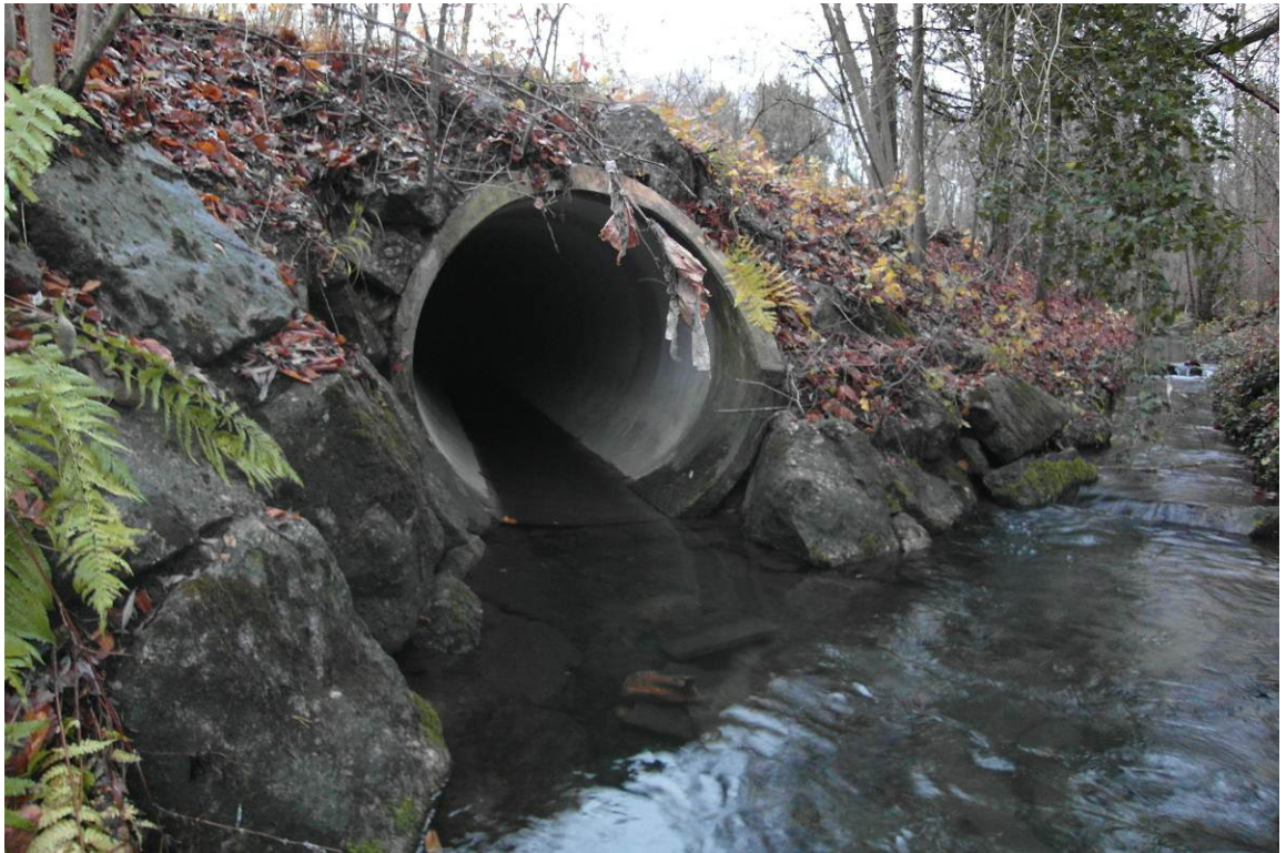
Abbildung 4: Einleitstelle des RB1 in den Sickerkanal, Bild vom 07.12.2011
