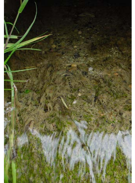
Abwasserpilz im Rohr
