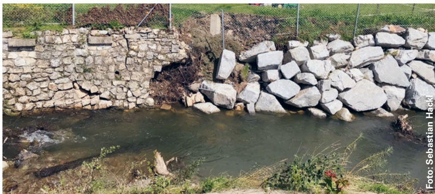
Der Übergang der alten zur neuen Mauer hielt dem Hochwasser nicht stand.
