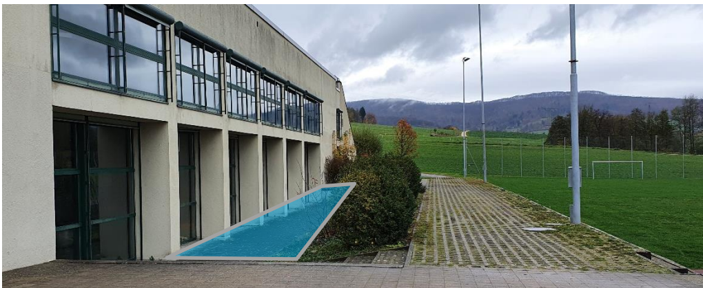
Abbildung 11: Ansicht Südwestfassade Schulhausgebäude mit markiertem Bereich, welcher einstaut
