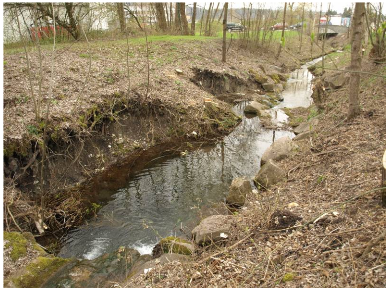
Abb. 13: Beispiel einer Ufererosion (Müli- bach Niederrohrdorf). In diesem Fall noch nicht kri- tisch, da kein angrenzendes Schadenpotential.
