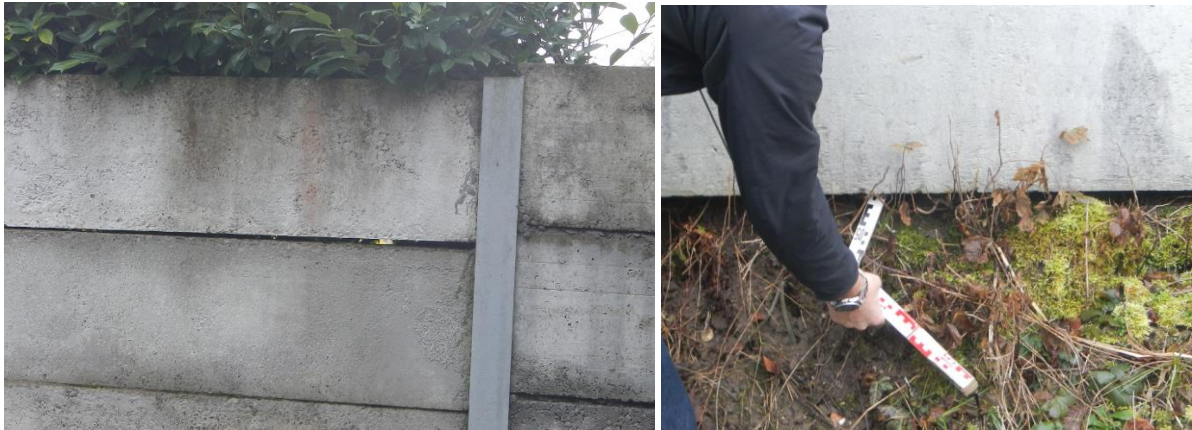
Abbildung 4: Fotos undichte Dammbalkenmauer (Begehung vom 08.02.2017)
