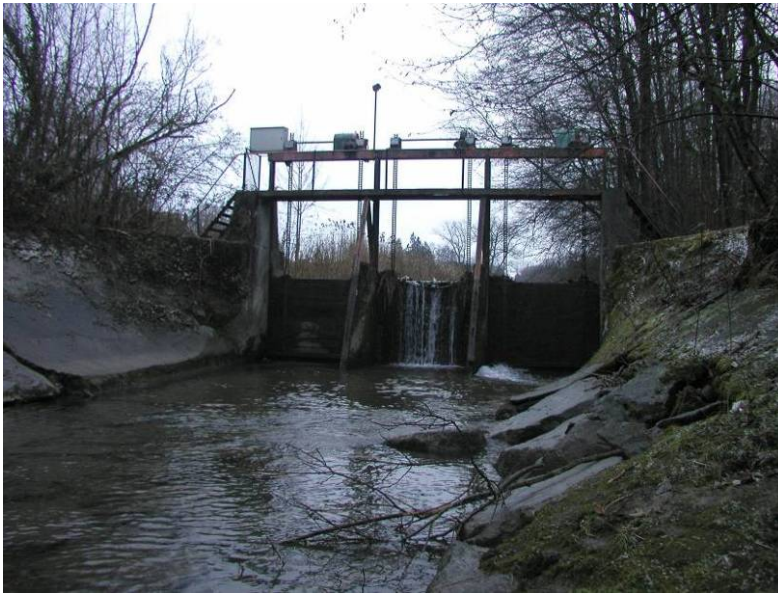
Bünz Dottikon Tieffurtmühle Km 7.895 Austrittsstelle D- Bü 13
