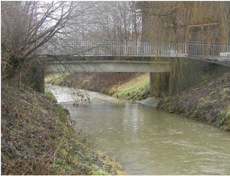
Bünz Waltenschwil Grottenweg Km 16.242 Austrittsstelle Wa- Bü 2
