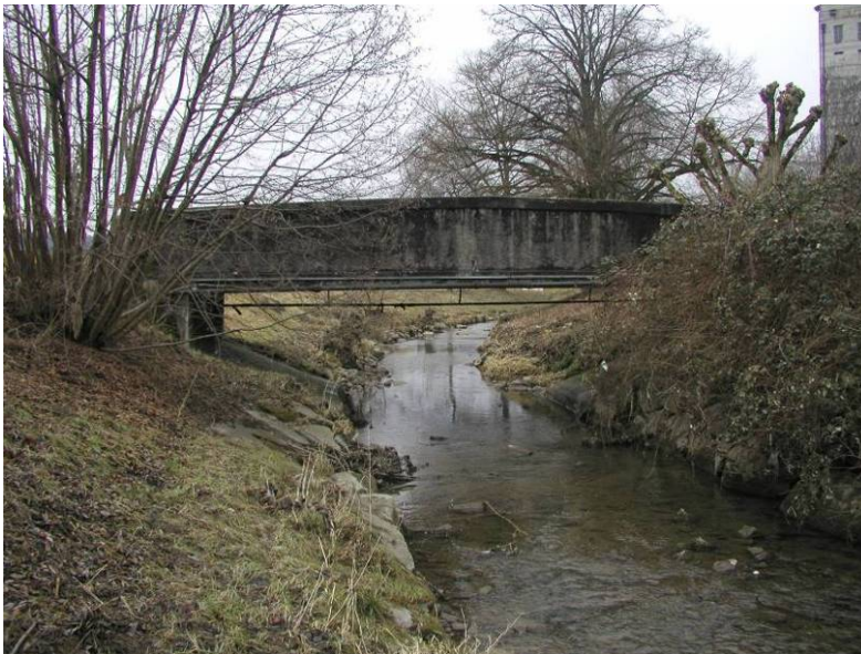
Bünz Dottikon Tieffurtmühle Km 7.827 Austrittsstelle D- Bü 13
