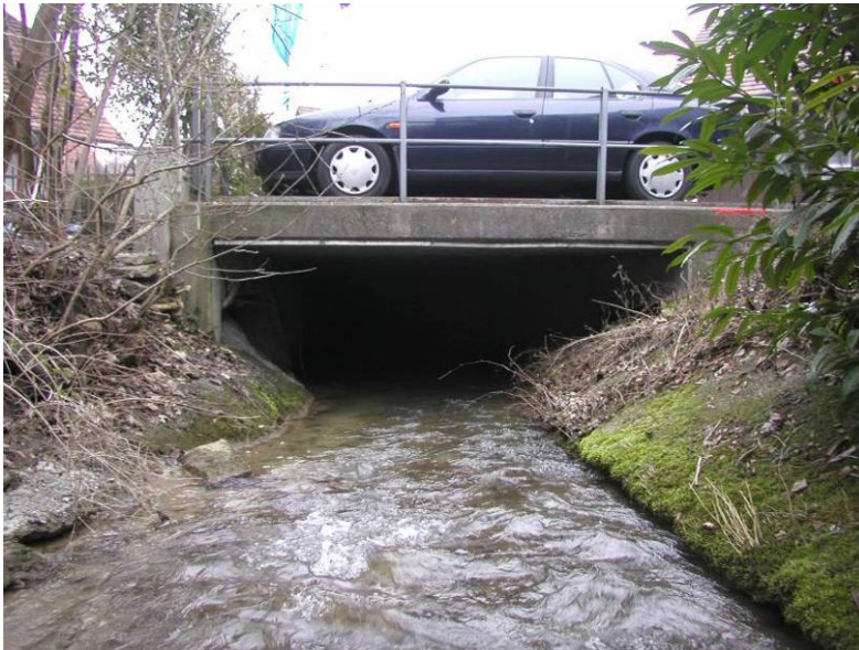
Erusbach Villmergen Bahnhofstrasse Km 0.996 Austrittsstelle V-Er 4
