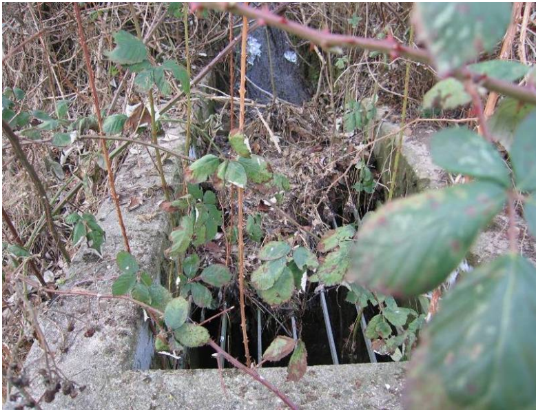
Rohrbach Dintikon Rohrstrasse Austrittsstelle D- Ro 1
