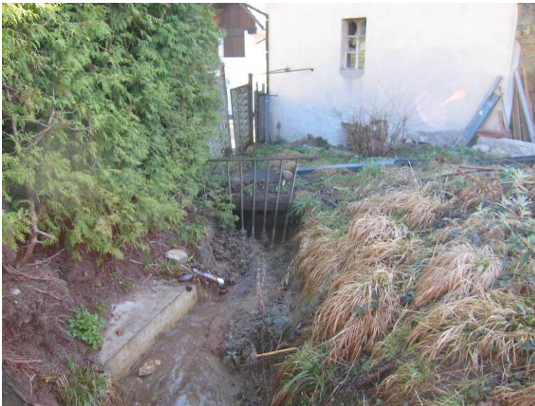
Rohrbach Dintikon Debistrasse Austrittsstelle D- Ro 1
