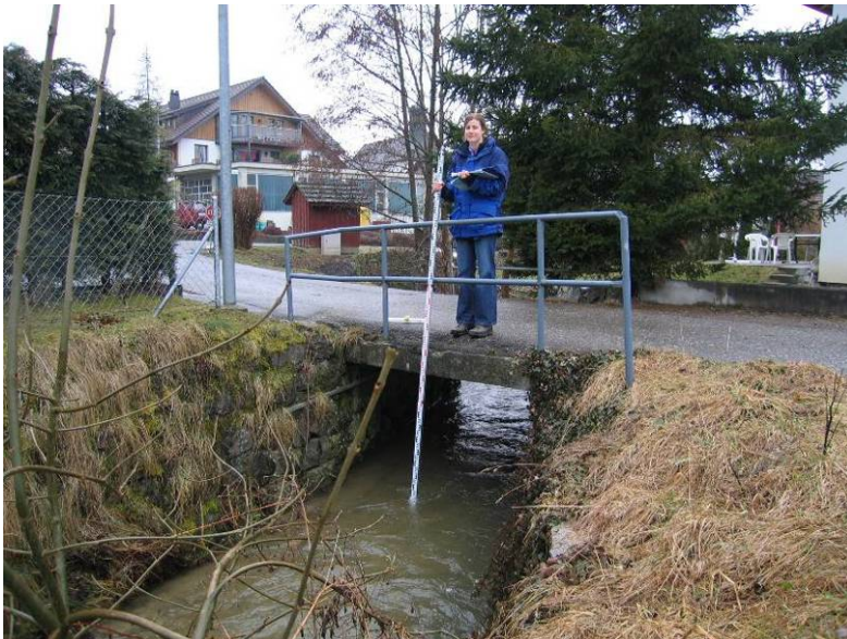
Hinterbach Bütikon Villmergerstrasse Austrittsstelle B- Hi 1
