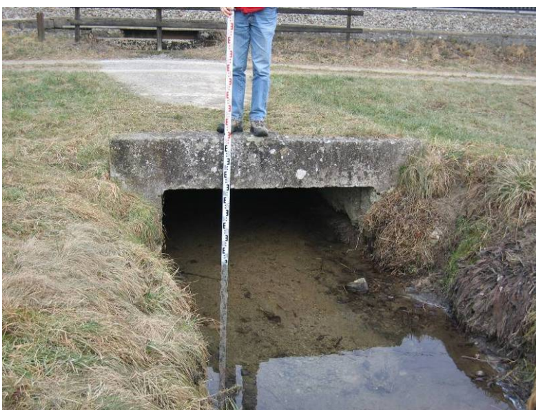
Krebsbach Hendschiken Bahndamm Austrittsstelle H- Kr 1
