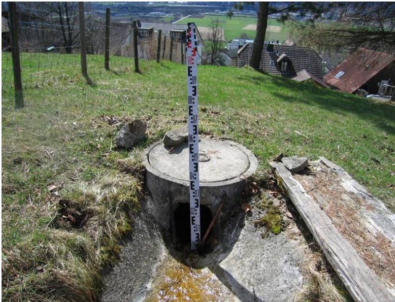
Reservoirbach Wohlen Anglikerbergstrasse Austrittsstelle W-Re 1
