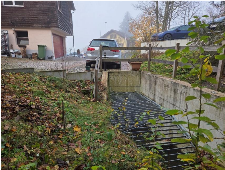
Abbildung 4: Neues Einlaufbauwerk mit Rechen
