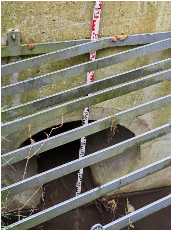
Abbildung 5: Neue Bachleitung mit Durchmesser 0.8 m (beim Einlauf)
